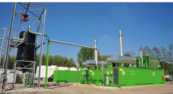
Moteur à gaz pauvre
