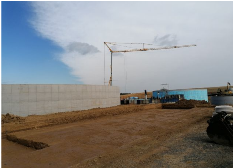
L'ensemble du site étanche. Autrement dit, en cas de fuite des installations, tout restera en surface.
